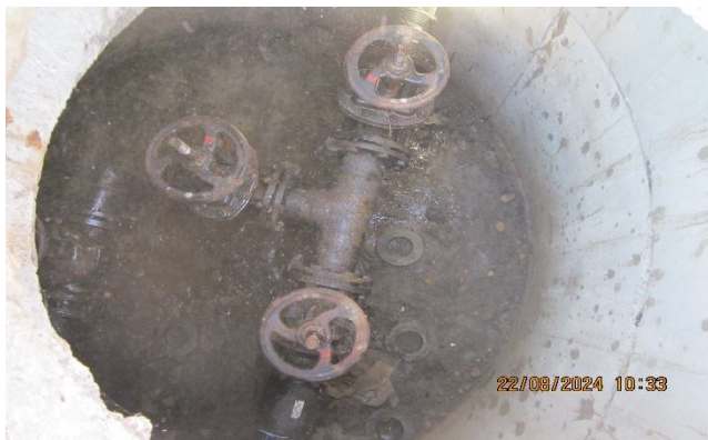
Состояние и внешний вид смотрового колодца.
